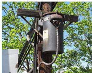
1930年代に製造された電柱上の変圧器 PCB使用機器であることを示すシールが 貼付されている(ウイキペディア掲載)
